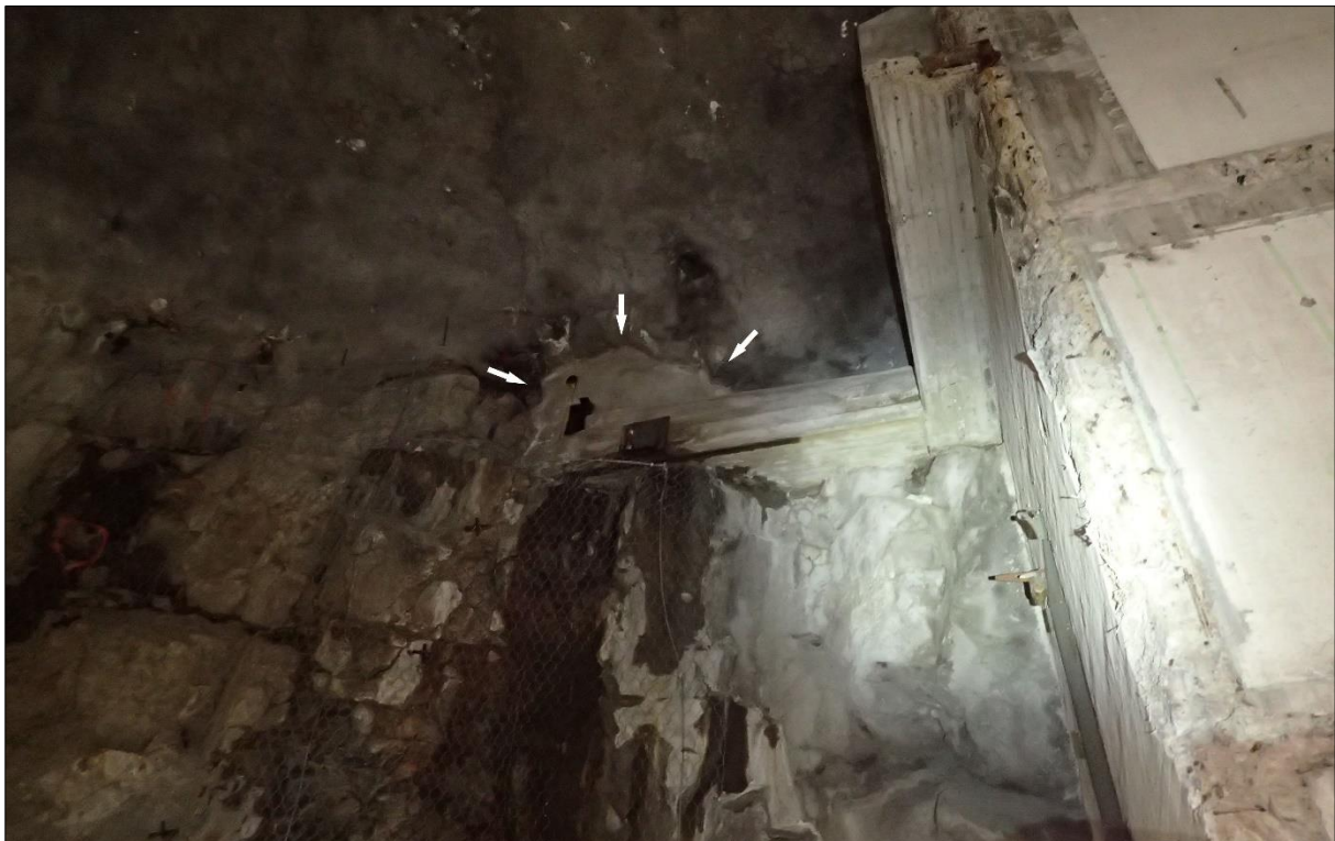
Figur 4-8 Foto som visar eventuellt läge för förseglat ventilationsschakt (vita pilar), samt därunder mörka fuktfläckar från inläckage.
