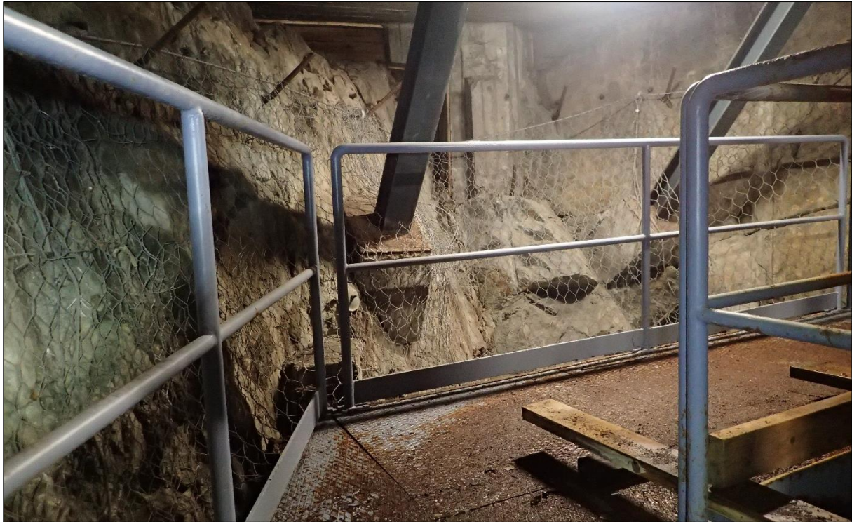
Figur 4-7 Foto av den översta delen av skorstenschaktet som visar inklädnaden i gabionnät.
