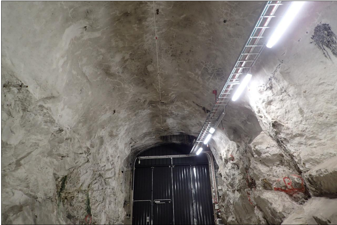
Figur 4-5 Foto av huvudentrén som visar sprutbetongtäckta anfang och tak. Väggarna är vitmålade men saknar sprutbetong. Ändar på förmodad systembult sticker ut ett par centimeter från taket. Röda spraymarkeringar på höger vägg visar på förekomsten av lösa block. Smärre krympsprickor är synliga i sprutbetongen.
